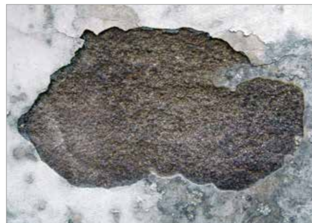
Mögliche Folgen von Feuchtigkeit im Mauerwerk sind Schimmelbildung, Abplatzen des herkömmlichen Putzes durch Salzablagerungen, allergische Reaktionen oder Atemwegsbeschwerden.
