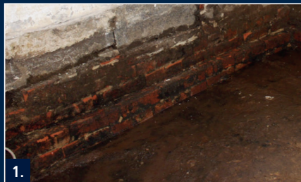
1. Aufsteigende Feuchtigkeit im Mauerwerk.
