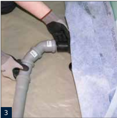
3 Anschluss der Water LD V an die Abwasserleitung.
