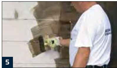
5 Grundieren mit BE 901 Bitumen-Voranstrich
