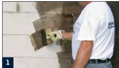
1 Grundieren mit BE 901 Bitumen-Voranstrich
