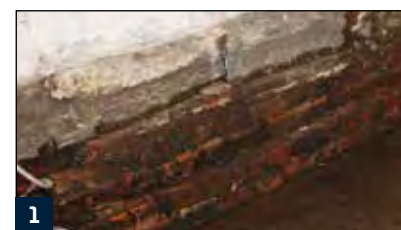
1 Aufsteigende Feuchtigkeit im Mauerwerk
