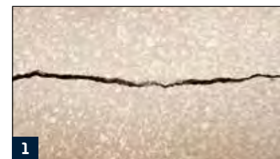
1 Riss im Estrich
