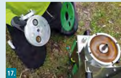
17. Förderpumpe wieder zusammenbauen.
