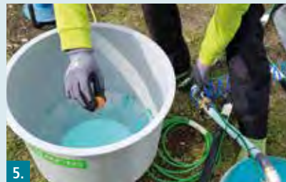
5. Beim Spülen mehrmals Schwammkugeln verwenden.
